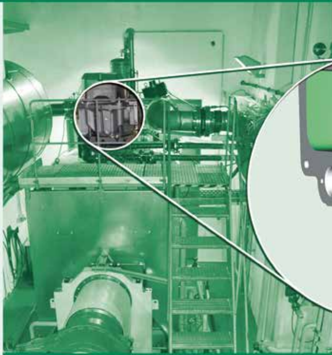
Gemischbildung an einem Gasmotor Mixture preparation of a gas engine
